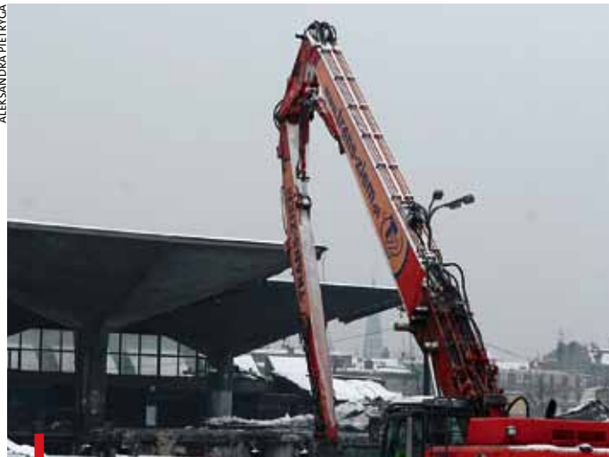
Olbrzymie maszyny pocięły jak papier żelbetowe ściany pierwszego z przerdzewiających kielichów reliktu dawnego systemu
