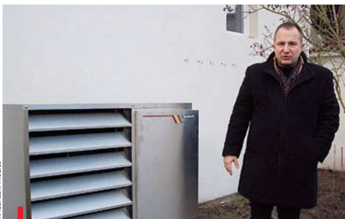
Anders Estinge przy powietrznej pompie ciepła ogrzewającej dom rekolekcyjny „Jackówka”
