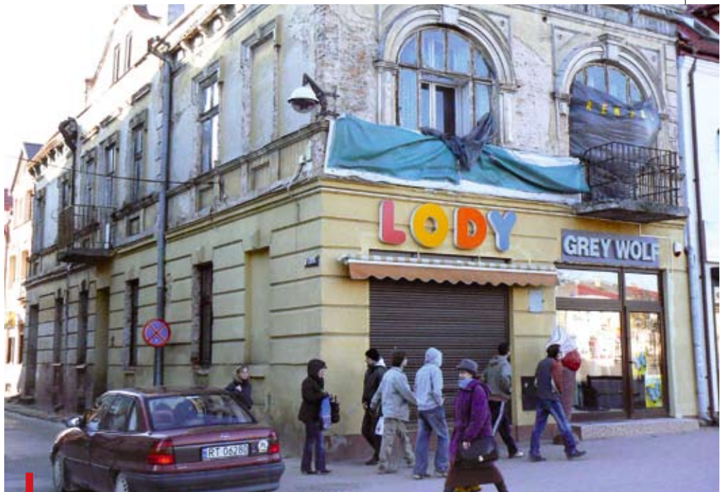
Zabytkowa kamienica w centrum Tarnobrzega nie tylko straszy wyglądem, stanowi również niebezpieczeństwo dla przechodniów
