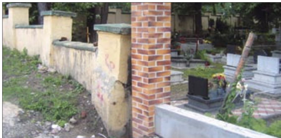
Ogrodzenie cmentarza jest już w bardzo złym stanie
