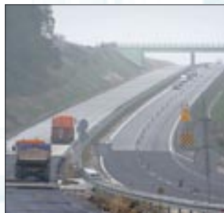
Remontowany fragment autostrady A4 na odcinku Legnica–Krzywe. Być może już za 2 lata będzie nią można dojechać aż do Zgorzelca
