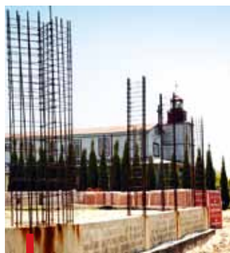
– Dzięki ofiarności parafian, nasza budowa osiągnęła poziom „zero”. Czas, by zaczęły rosnąć mury – mówi proboszcz
